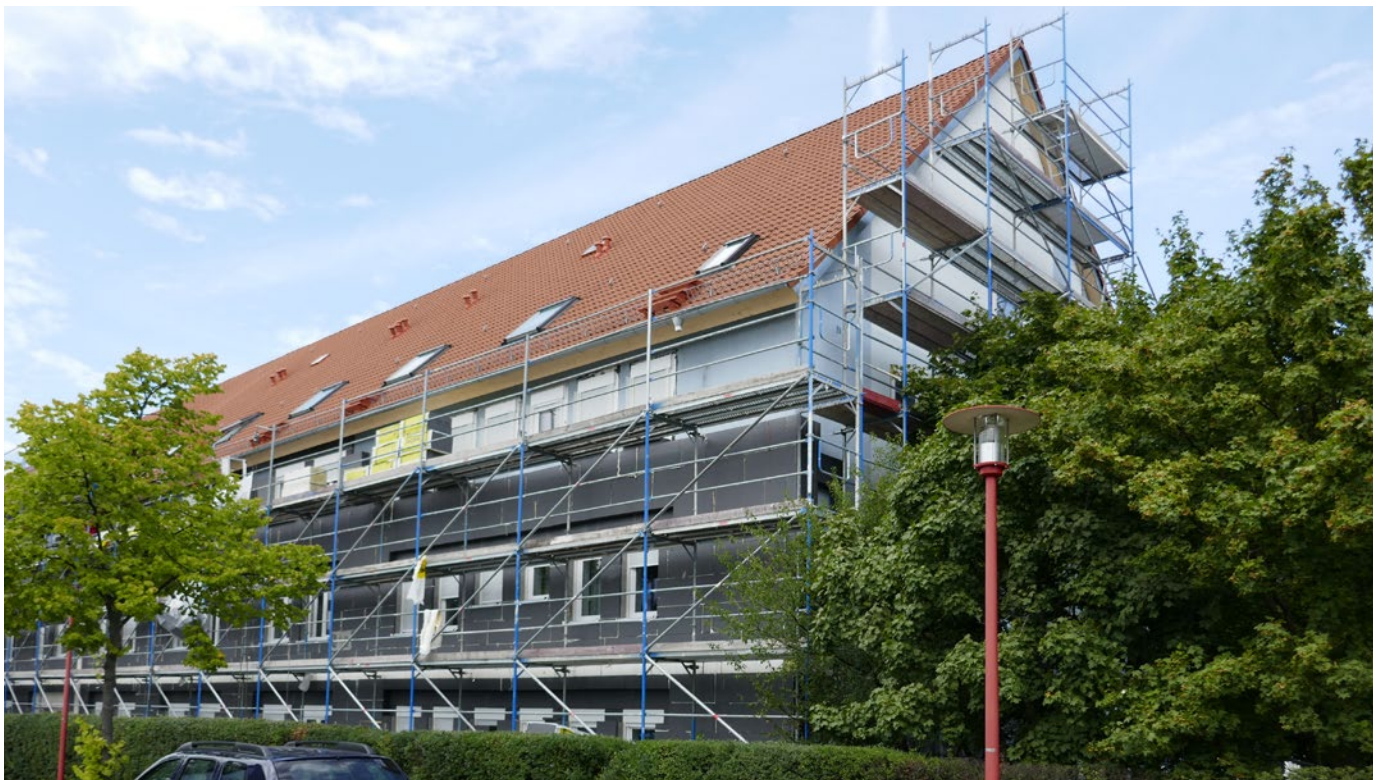
Integrales Energiespar-Contracting Studentensiedlung Ludwig-Frank, Studierendenwerk Mannheim
