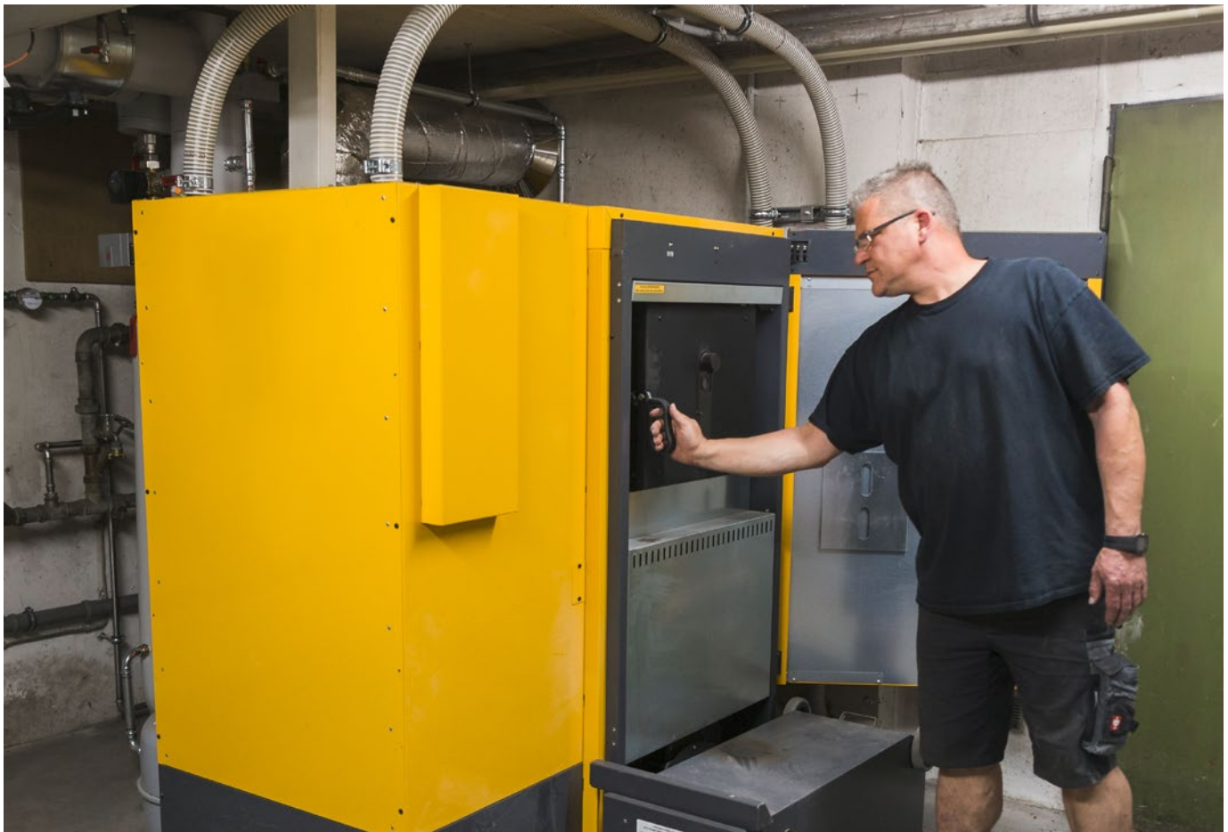
Pelletheisanlage im Bauhof Pfinztal
