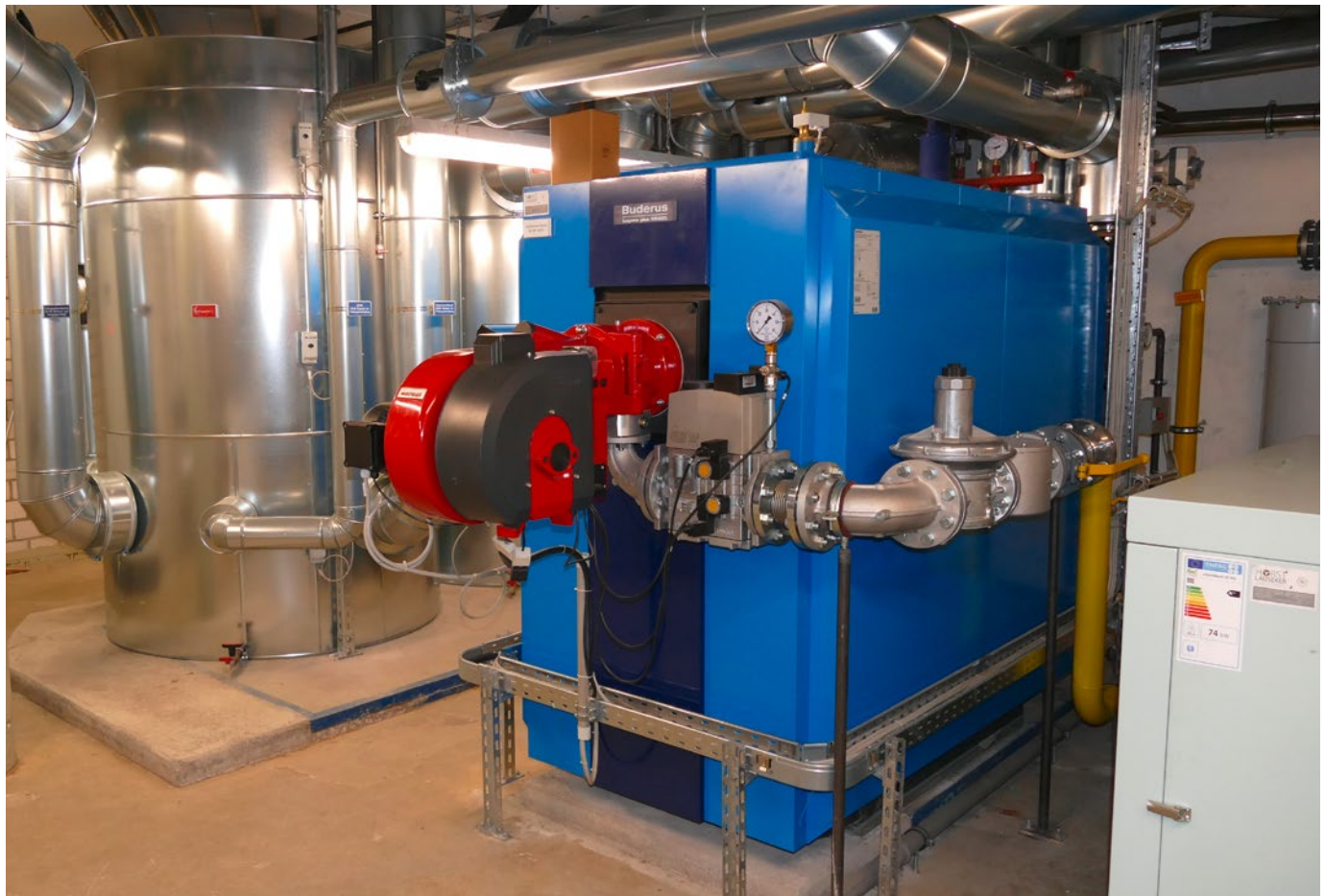
Heizzentrale des Energiespar-Contracting-Projektes Altenhilfezentrum Karlsruhe-Nordost mit Pufferspeicher, Spitzenlastkessel und BHKW.
