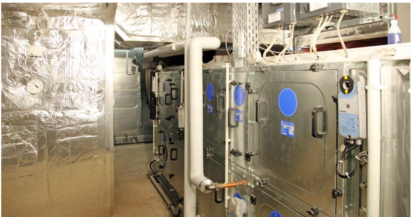
Lüftungszentrale Ludwig-Wilhelm-Gymnasium Raststatt
