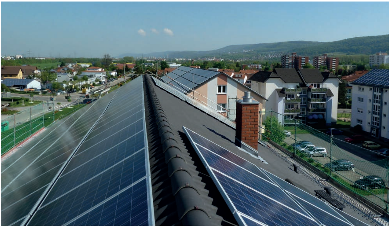
Abb. 23: Mieterstromprojekt der Heidelberger Energiegenossenschaft eG (Quelle: HEG)
