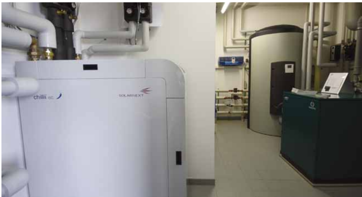
Bild 1: BHKW mit Pufferspeicher (hinten rechts) und Adsorptionskältemaschine (vorne)
