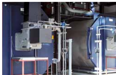
Bild 3: Heizkessel (Großwasserraumkessel) im Fernheizwerk Waldhäuser Ost
