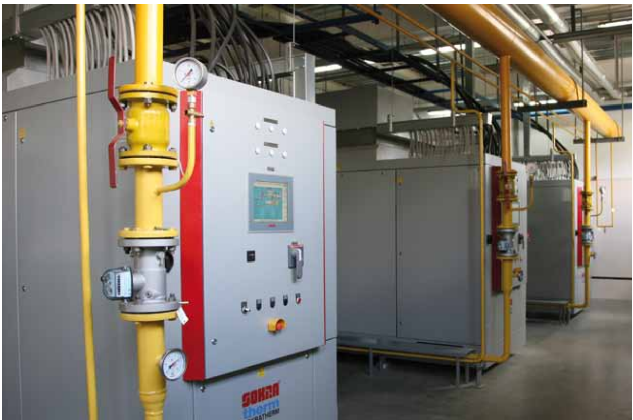
Bild 2: BHKW-Anlage 3 x GG 201
