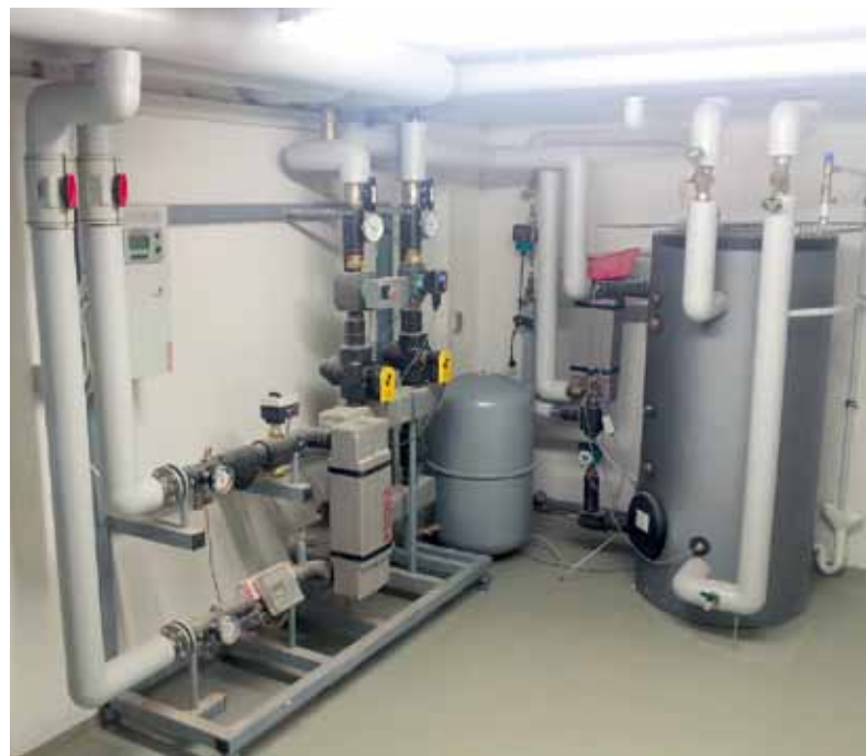
Bild 3: Übergabestation im Gebäude
