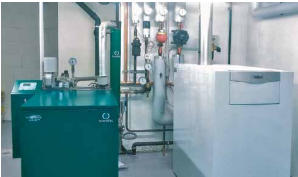
Bild 2: BHKW-Dachs mit Spitzenlastkessel
