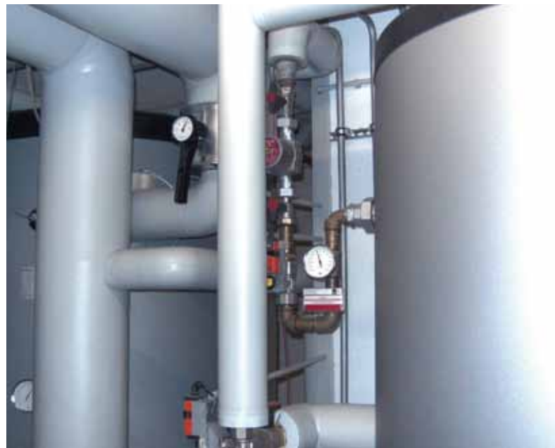
Bild 3: Pufferspeicher mit Hydraulik
