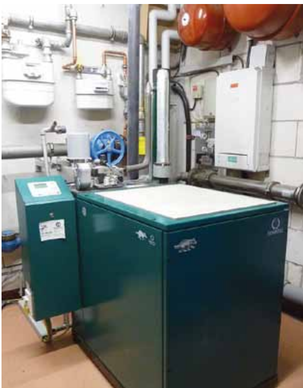
Bild 2: BHKW SenerTec Dachs in der Heizzentrale
