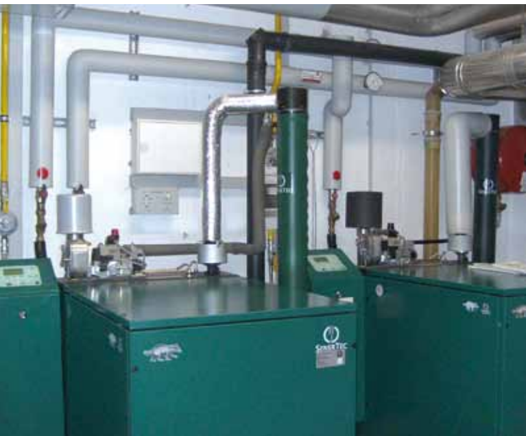
Bild 2: Heizzentrale mit den beiden Dachs-BHKW
