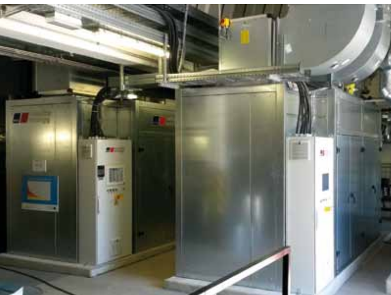
Bild 2: Heizzentrale mit BHKW
