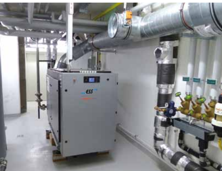
Bild 2: BHKW im Heizraum
