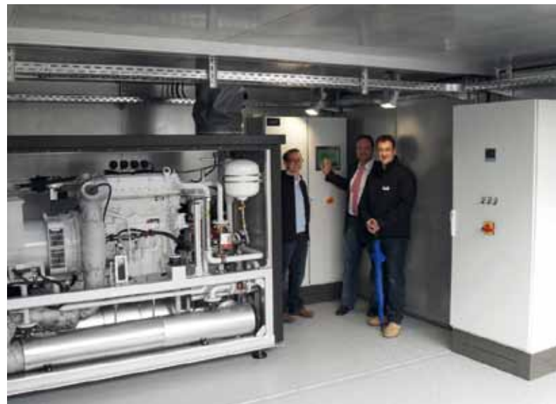
Bild 3: Heizraum mit BHKW
