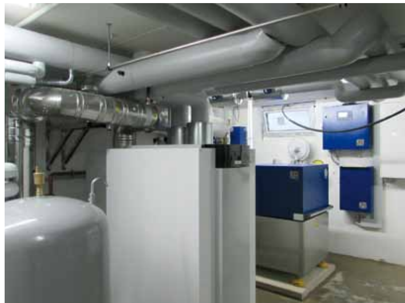
Bild 3: Kessel und BHKW
