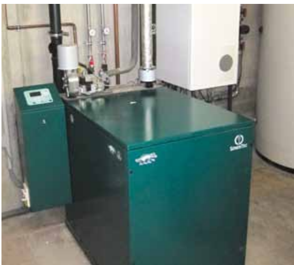
Bild 2: BHKW im Heizraum
