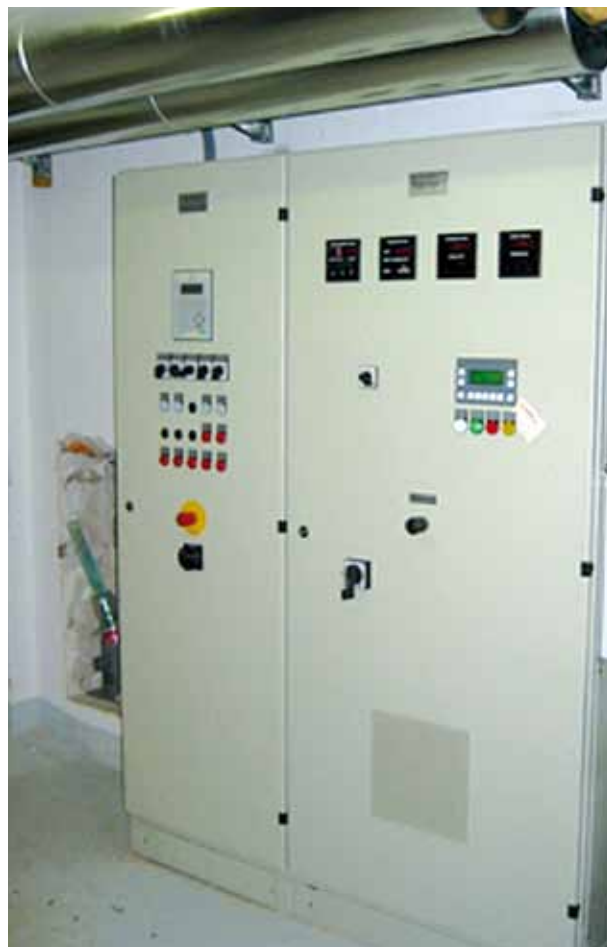
Bild 1 (links): Heizzentrale und Wohnhaus Bild 2 (oben): Steuerung
