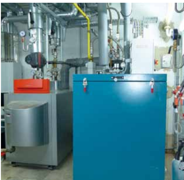
Bild 2: BHKW im Heizraum
