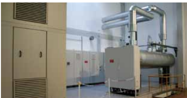
Bild 2: Elektrokessel 5 MW th im Fernheizwerk Waldhäuser Ost
