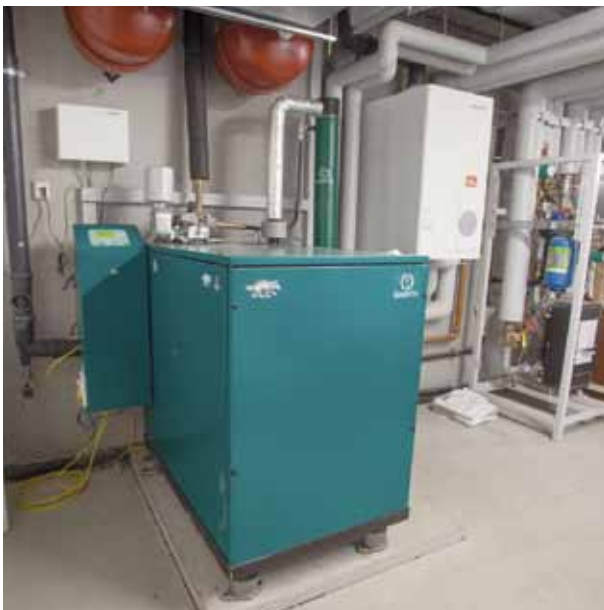
Bild 2: Eins von vier Dachs-Blockheizkraftwerken im Hotel Ritter
