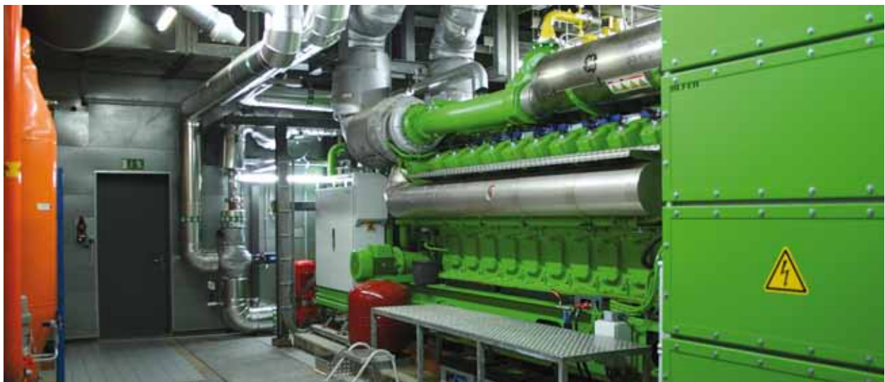
Bild 1: Gasmotor 3,35 MW el , von insgesamt 4 Motoren des BHKW Obere Viehweide
