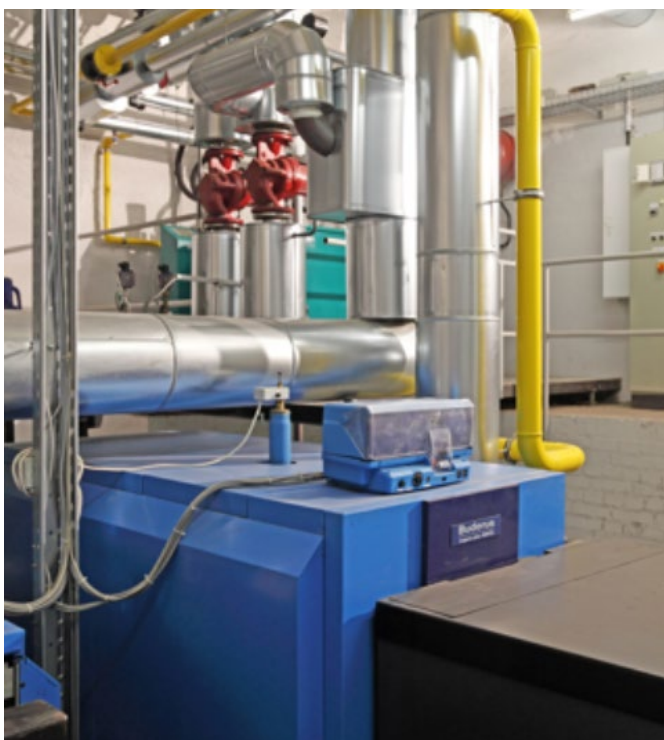
Heizzentrale Ludwig-Wilhelm-Gymnasium Raststatt
