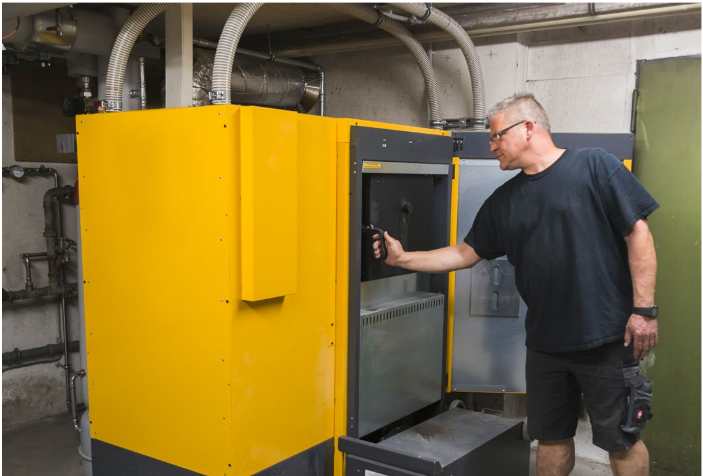
Pelletheisanlage im Bauhof Pfinztal
