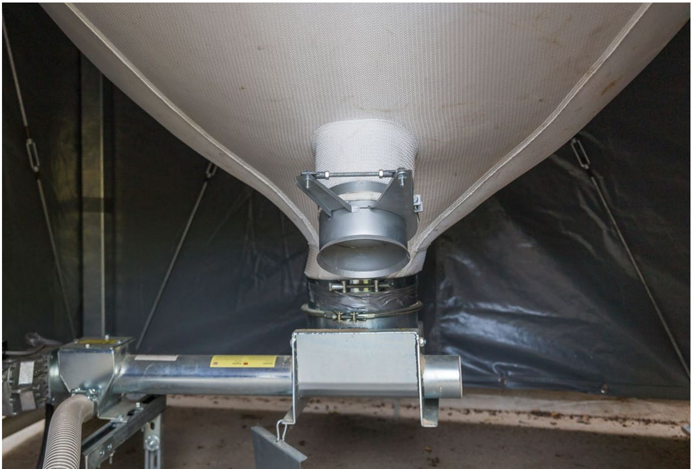
Pelletlager im Bauhof Pfinztal
