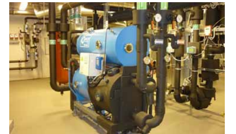
Abbildung 50: Technikraum mit AKA
