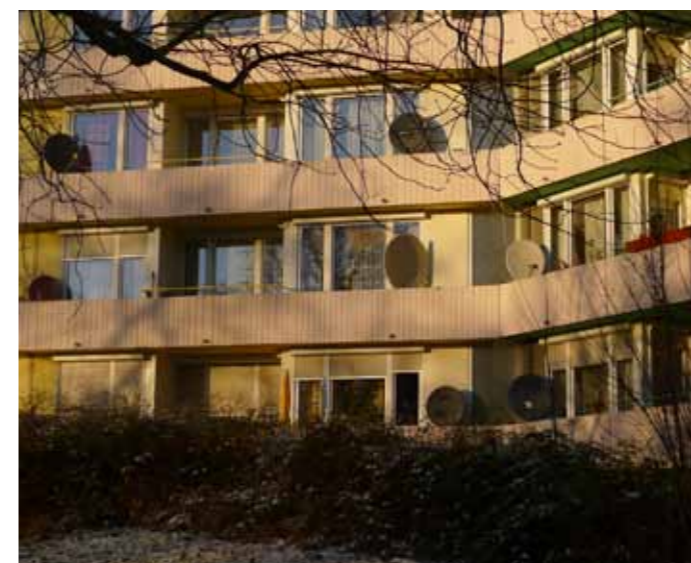
Abbildung 69: Herausforderung für die Fassadensanierung
