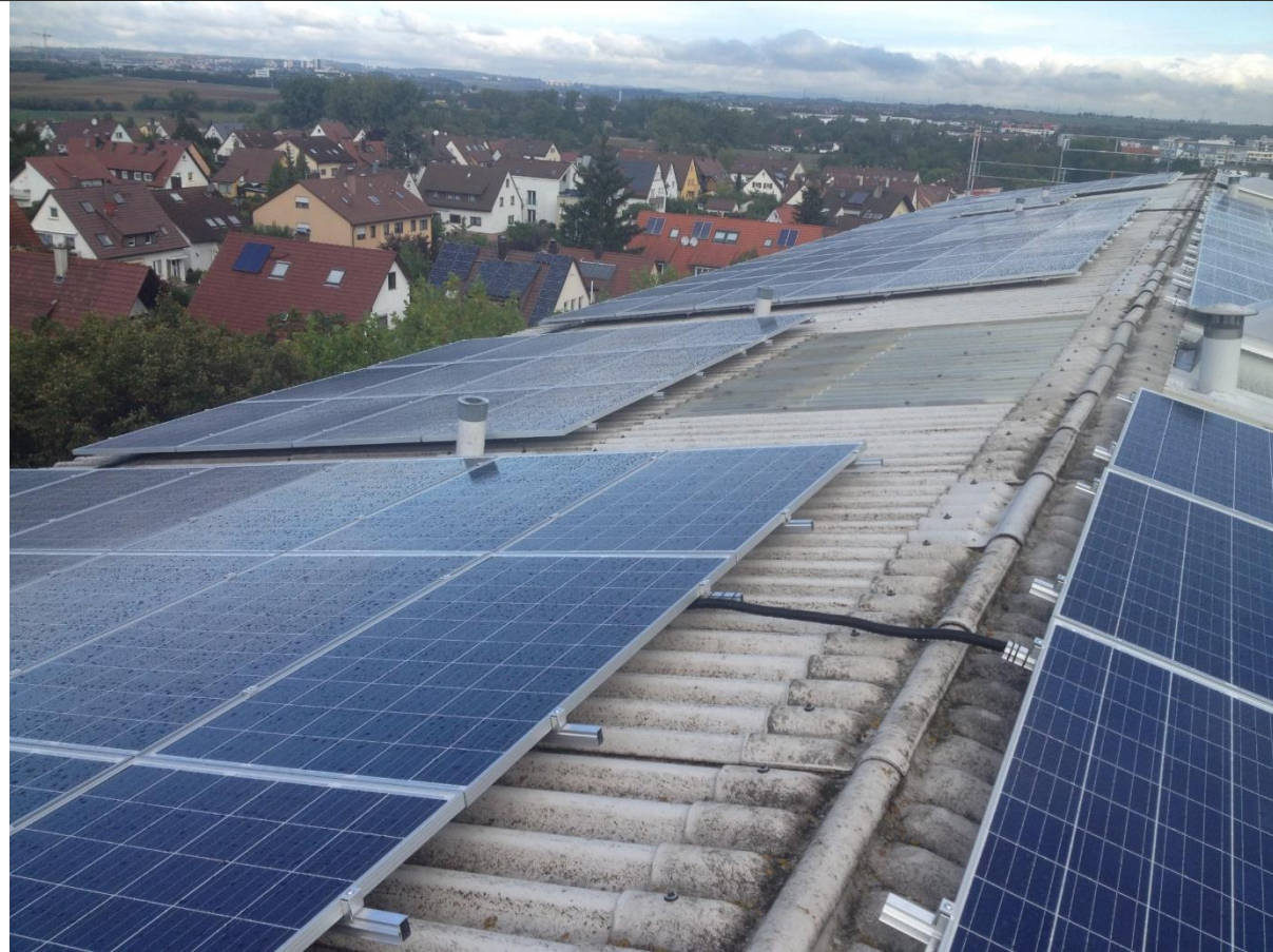
PV-Dachanlage Quelle: ZEAG Energie AG
