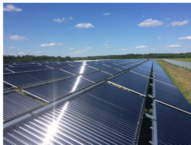
Komponente zur Bereitstellung innovativer erneuerbarer Wärme
