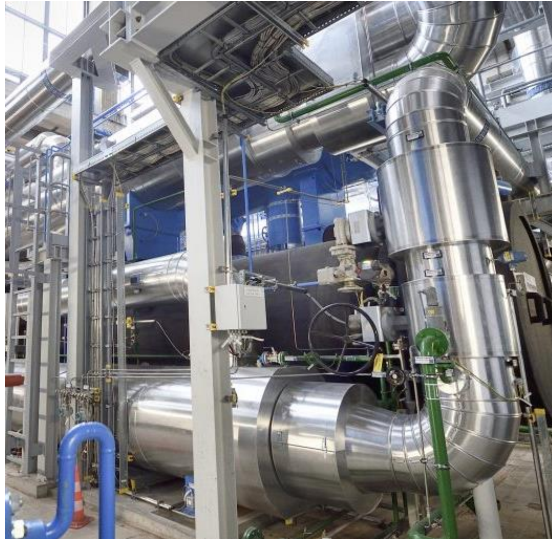
27 MW th -Wärmepumpe Wien-Simmering © Wien Energie GmbH / Christian Hofer
