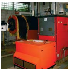
Kesselanlage in der Pestalotzzi Schule, Ettlingen
