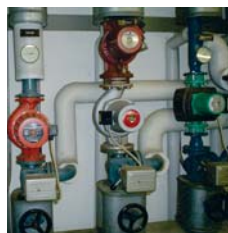
Pumpenmix in Schopfheim
