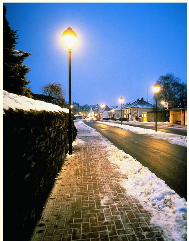
Energiesparende Kompaktleuchtstofflampen mit geringer Lichtpunkthöhe
