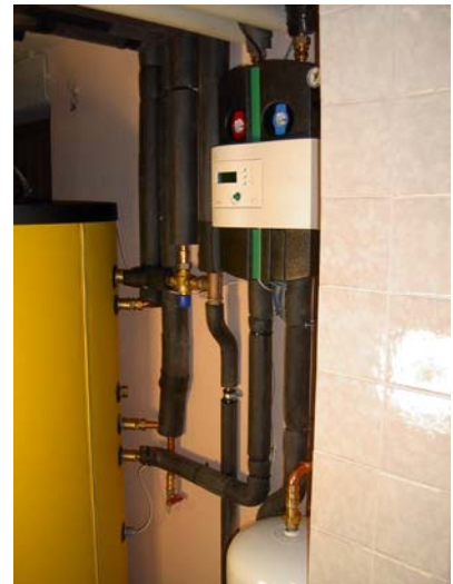
Speicher und Solarregler
