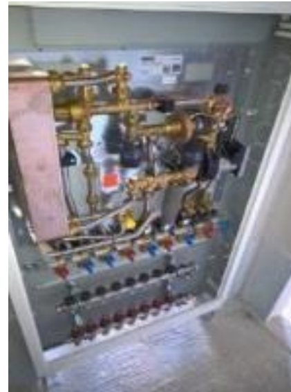
Wohnungsübergabe mit FBH-Verteiler
