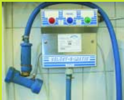
Mischanlage für Reiniger
