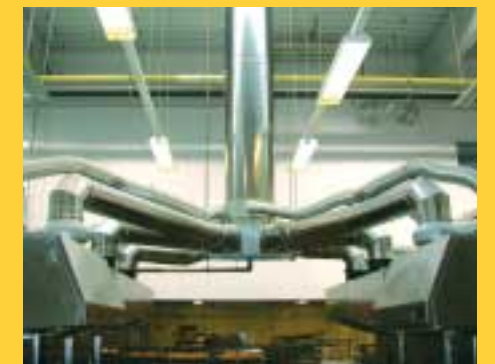
Abwärme-Rückgewinnung an Stickenöfen
