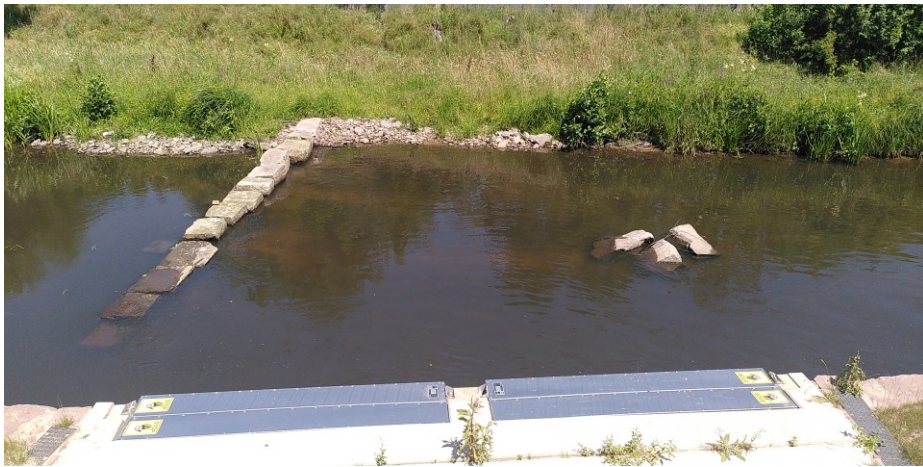
Entnahmebauwerk (mit Schmutzfang; strömungstechnisch optimiert, um Schmutzeintrag zu reduzieren)
