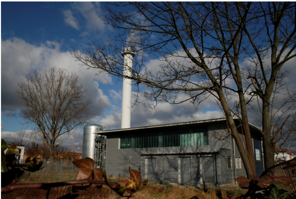
Foto: Heizzentrale des Nahwärmenetzes Quartier Normand © SWS Speyer GmbH
