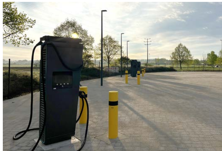
Ladeinfrastruktur für Busse, gestellt vom Landkreis Karlsruhe (Foto: Stutensee/FC Planung GmbH)
