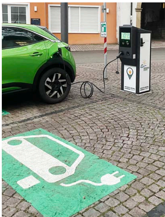
Die Ladesäule in Dielheim nutzt erneuerbare Energie (Foto: BEG Kraichgau)
