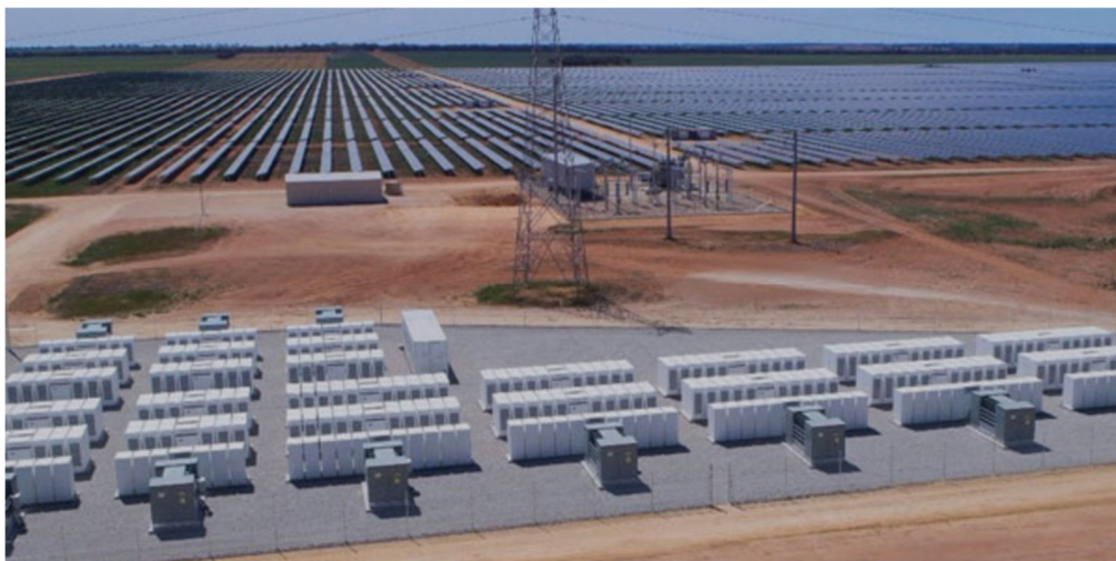
Abb. 13: Groß-Stromspeicher im 100 Megawatt Bereich mit PV Anlage Quelle: https://www.startupworld.com/news/tesla-new-magapack-product/
