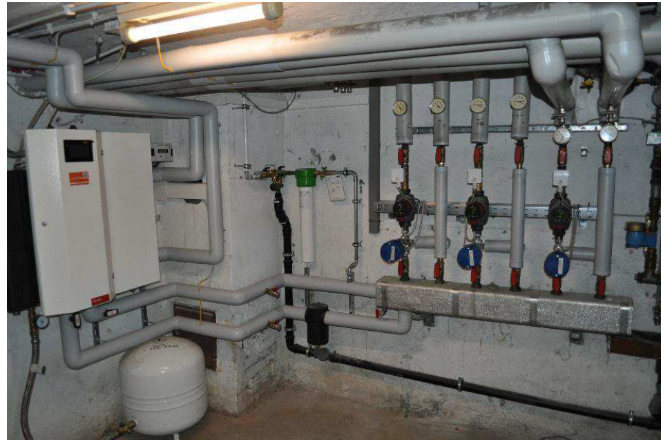
Heizzentrale mit Nahwärmeübergabestation
